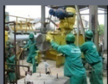
Mantenimiento de Equipos
